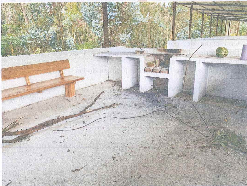
Instalaciones descuidadas y abandonadas
