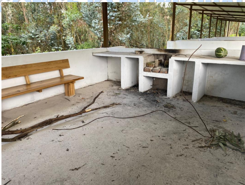
Instalaciones descuidadas y abandonadas
